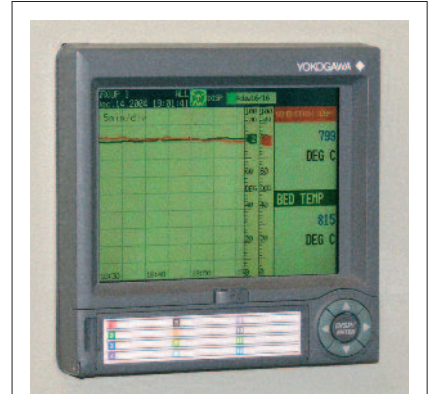
L'enregistreur graphique permet de contrôler la température dans la chambre de combustion de l'épurateur pour indiquer le taux de destruction des CO et COV. Photo MEGTEC.
